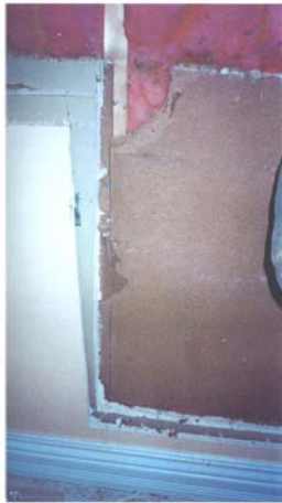
Photo #7 Aperçu de l'ouverture pratiquée dans le mur mitoyen dans le salon. On note les taches au bas du panneau de laine, ce qui indique que l'eau s'est bien accumulée dans la laine au contact du matériau de carton-fibre.
